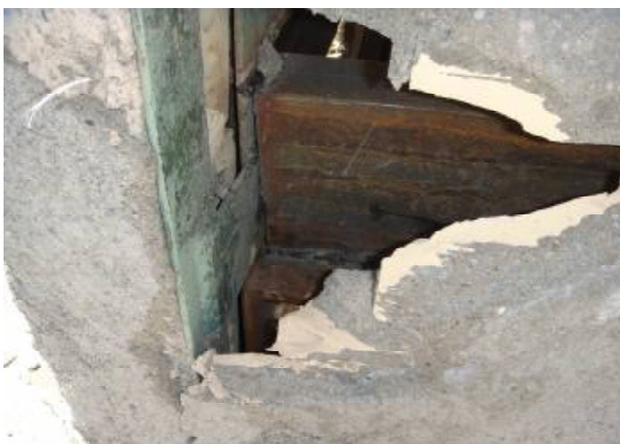
اتصال غیرمصوب شاسی موتور آسانسور به سازه ساختمان
