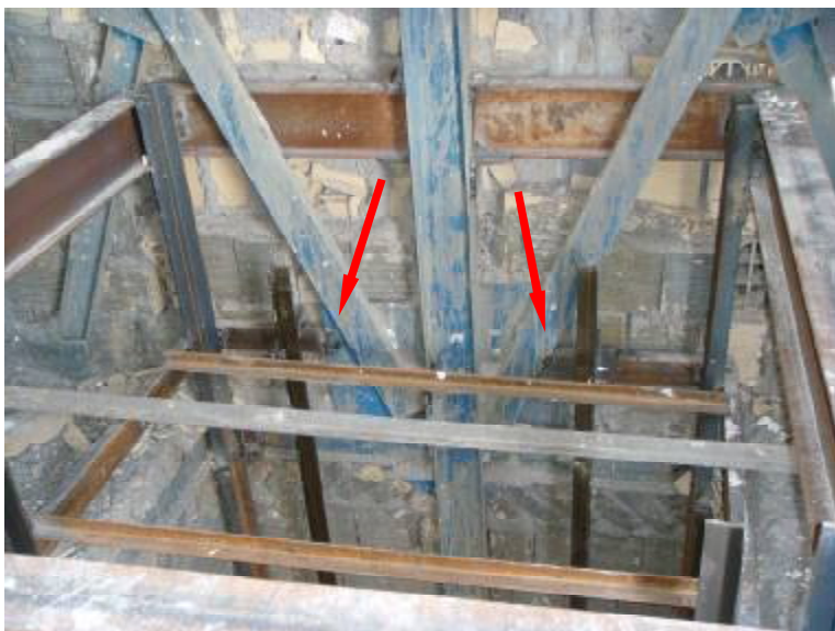
اتصال شاسی و آهنکشی آسانسور به مهاربند ساختمان
