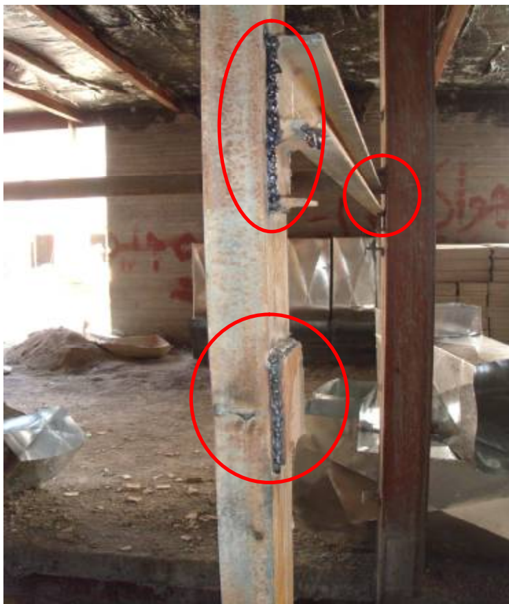
اتصال غیرمصوب ناودانی و ورق وصله آهنکشی آسانسور
