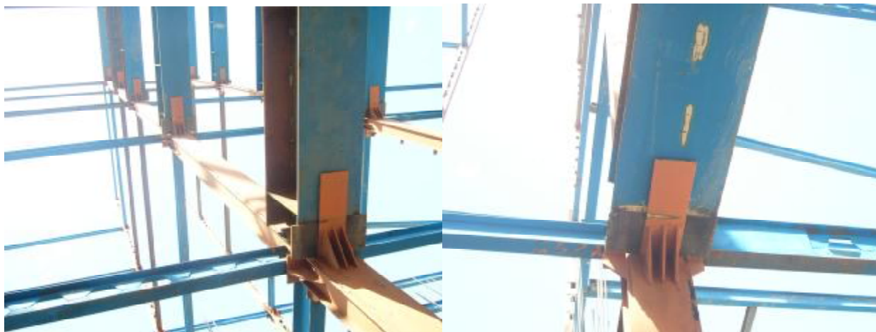
عدم نصب صحیح زیرسریها در تیر ورقها
