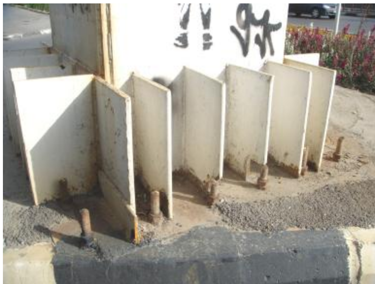
عدم مونتاژ و نصب صحیح سخت کننده های پایه دکل تبلیغاتی
